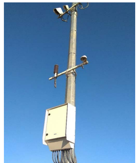
Рисунок 6. Смонтированная метеостанция на объекте мониторинга
