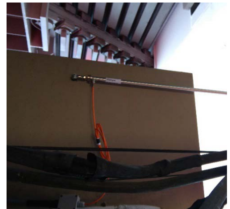
Рисунок 5. Смонтированные датчики линейных перемещений на объекте мониторинга
