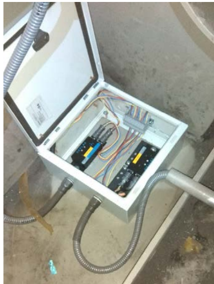
Рисунок 2. Смонтированные акселерометры на объекте мониторинга
